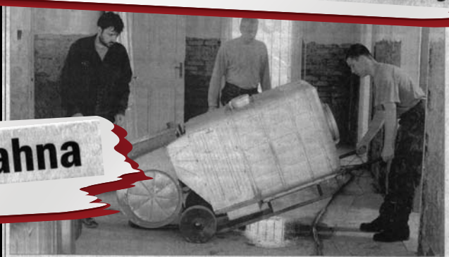
OPRAVA ŠKOLY. V Základní škole Komenského v Kralupech nad Vltavou vyuka nezačala. Po povodni je škola zničená a v těchto dnech se tam pracuje na vysoušení objektu. FOTO: MAFIA - RADEK CHLA
